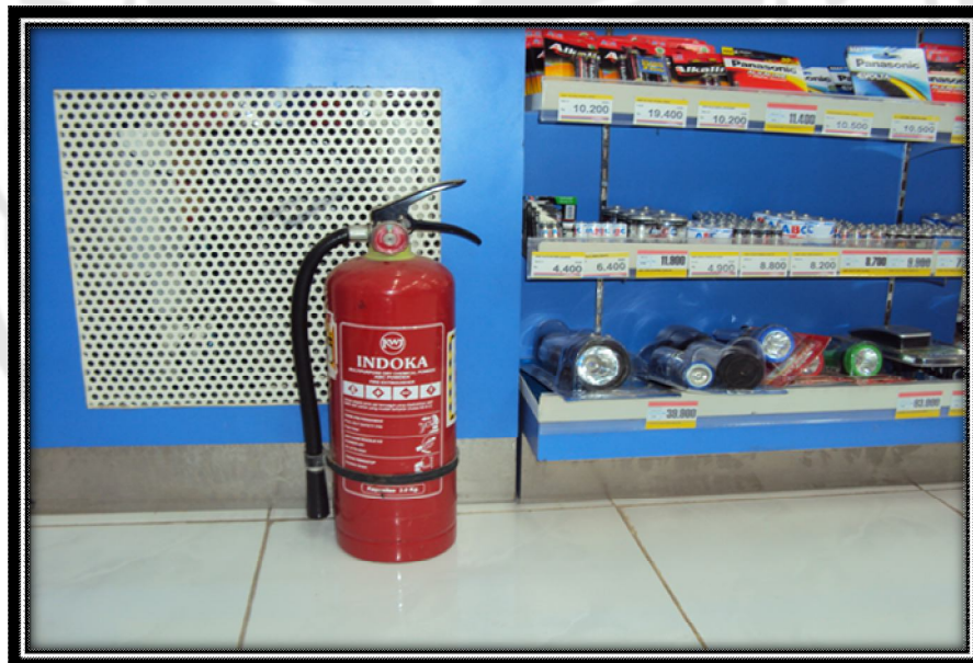
Fasilitas Pemadam Kebakaran (Foto: Dody Ardo, 2011)
